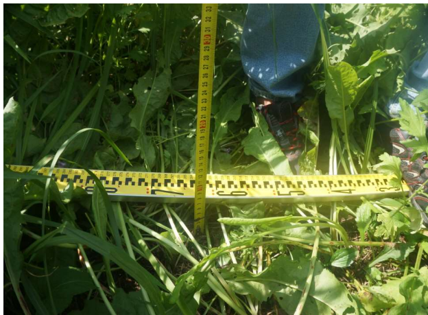
배수지 상부 토사침하
