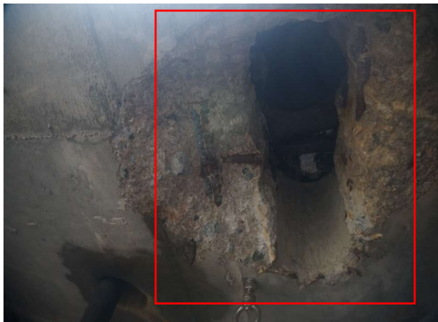
유입밸브실1지 상부슬래브 철근노출
