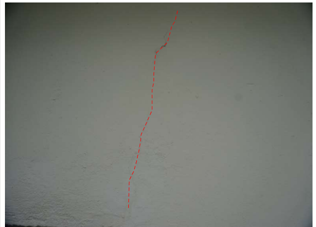
계단실 외부 벽체 균열(모르타르)
