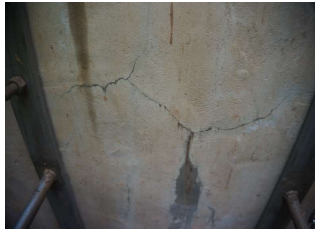
유출밸브실1지 벽체 균열(0.3mm미만)
