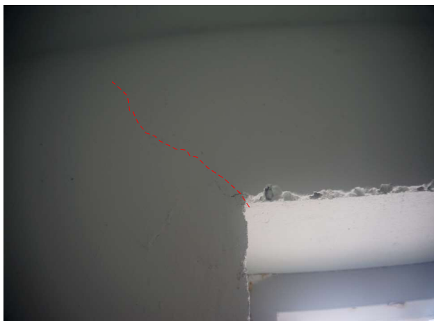
계단실 내부 벽체 균열(모르타르)
