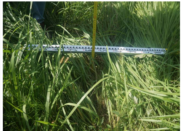
배수지 상부 패임
