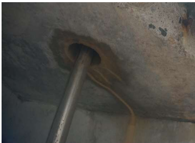
유입밸브실2지 상부슬래브 누수흔적
