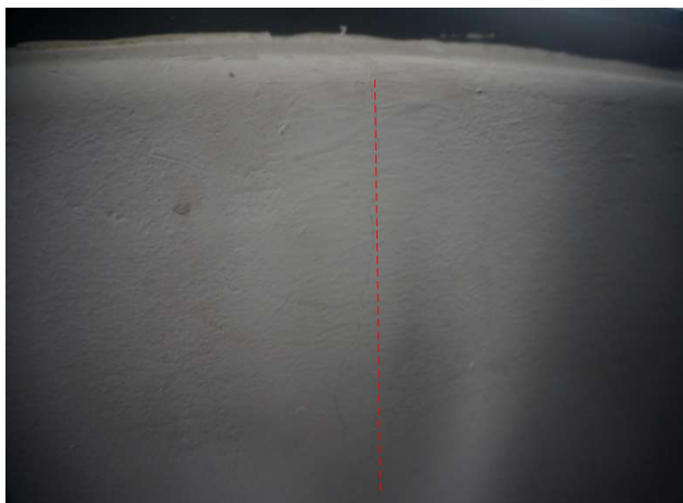
건축물(관리동) 내부 균열(0.3mm이상)
