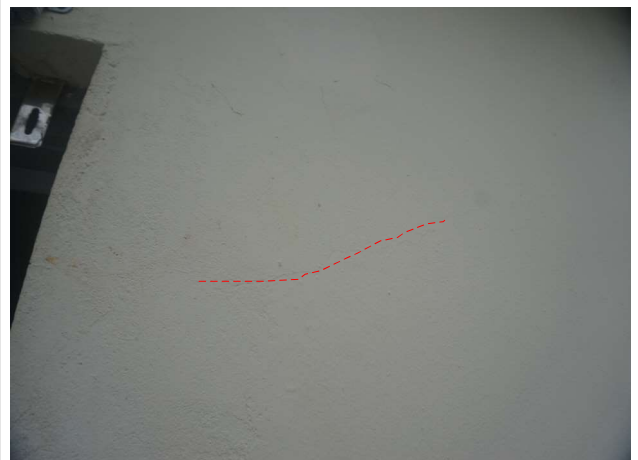
계단실 외부 벽체 균열(모르타르)
