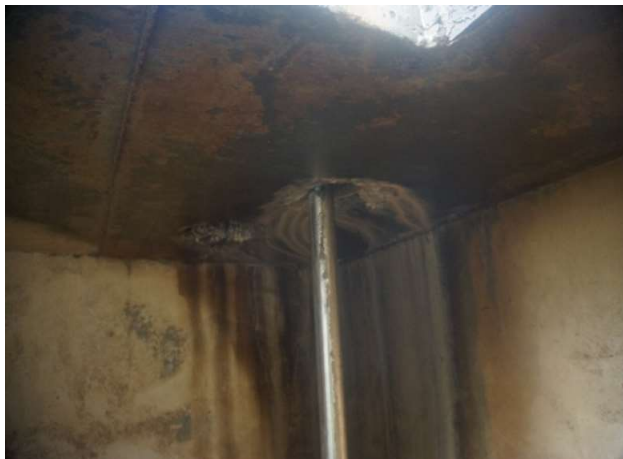
유출밸브실1지 상부슬래브 누수흔적
