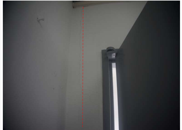
건축물(관리동) 내부 균열(0.3mm이상)
