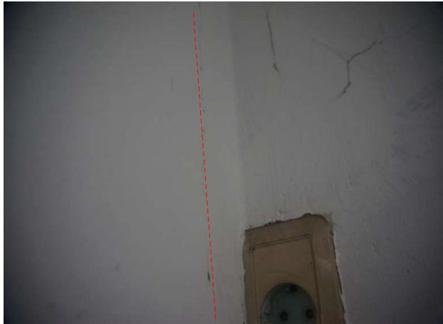
건축물(관리동) 내부 균열(0.3mm이상)
