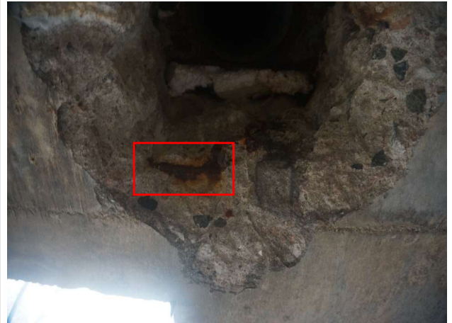
유입밸브실2지 상부슬래브 철근노출
