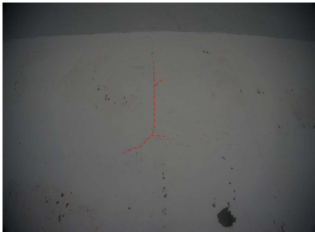
계단실 내부 벽체 망상균열(모르타르)
